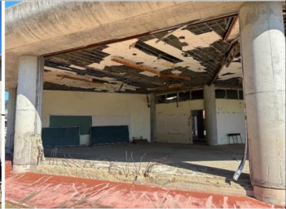
外壁が破壊された教室
